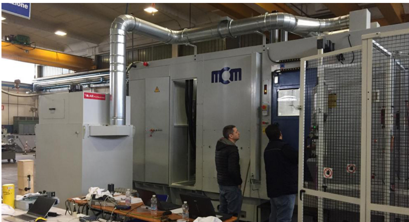
INSTALLAZIONE COALFILTER SU CENTRO DI LAVORO MCM
